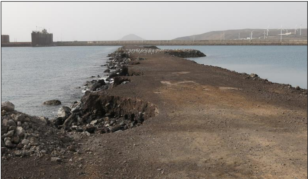
Figura 2 Erosión por oleaje en la mota de cierre perimetral (19/01/2022)
