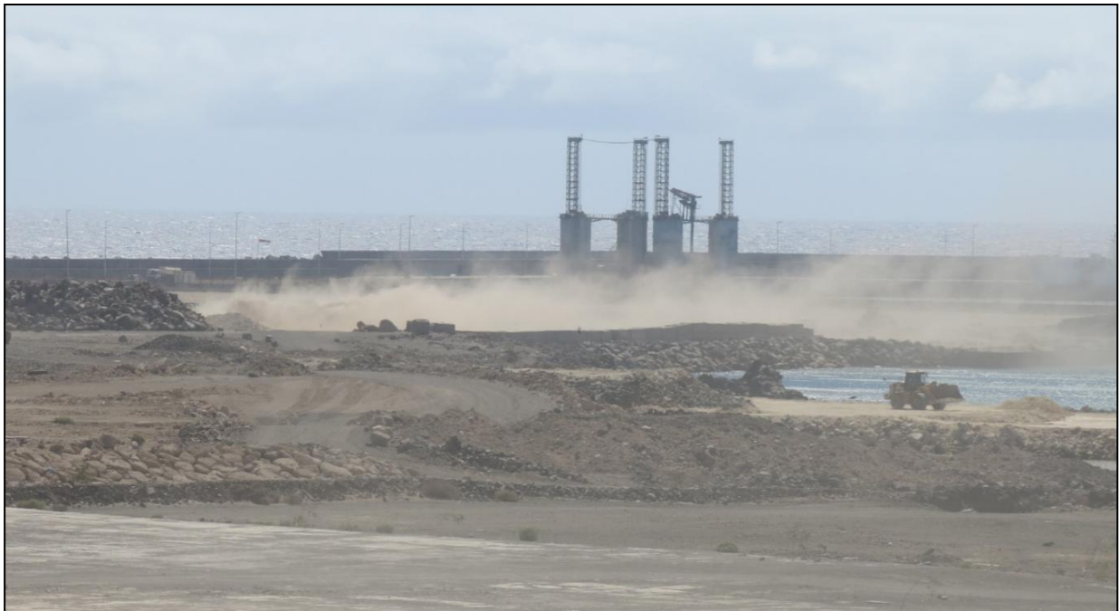
Figura 11. Polvaredas de considerables dimensiones durante los trabajos de relleno de la explanada principal del puerto (agosto de 2020)
