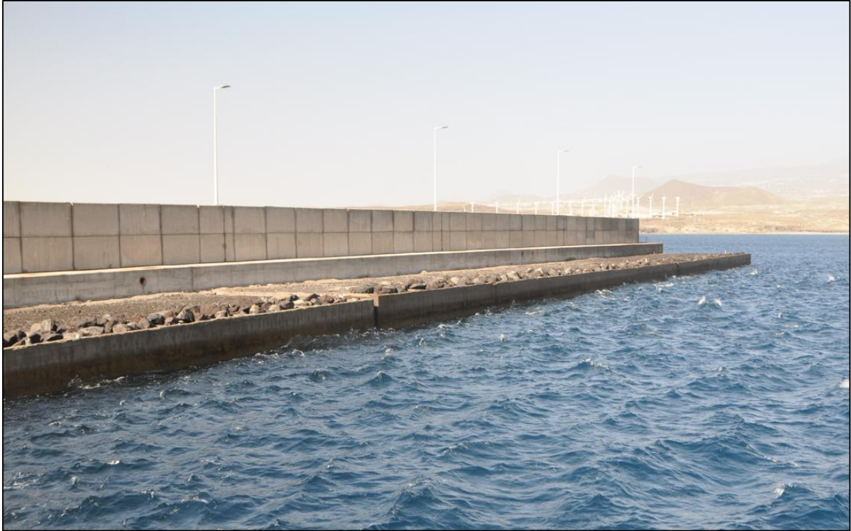
Figura 17: Cajones al descubierto del martillo de la obra de abrigo
