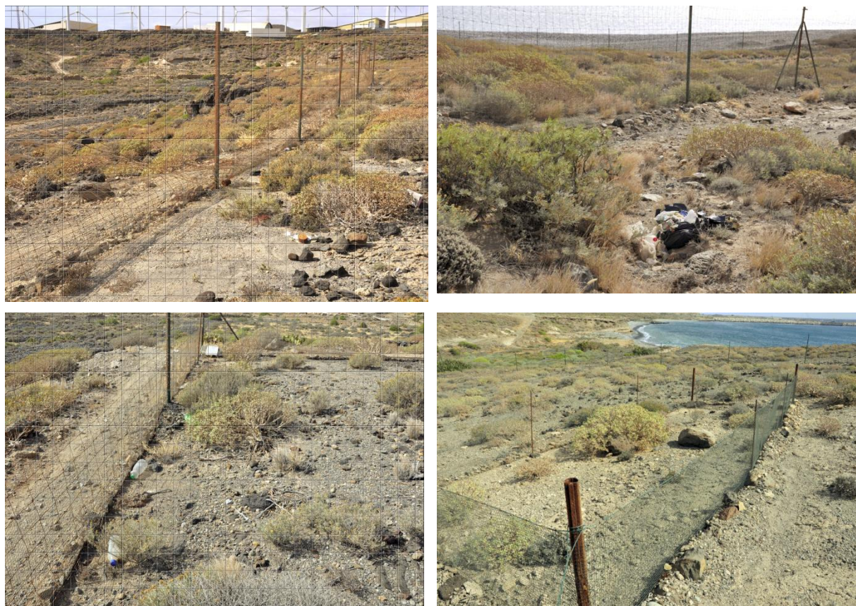
Figura 22. Situación de la zec a finales de 2015. Vallas rotas (a) y presencia de basuras (b-c). Los cerramientos interiores (d) se encuentran en mejor estado y algunos siguen siendo funcionales e impiden el acceso de los conejos a los pies de piñamar.
